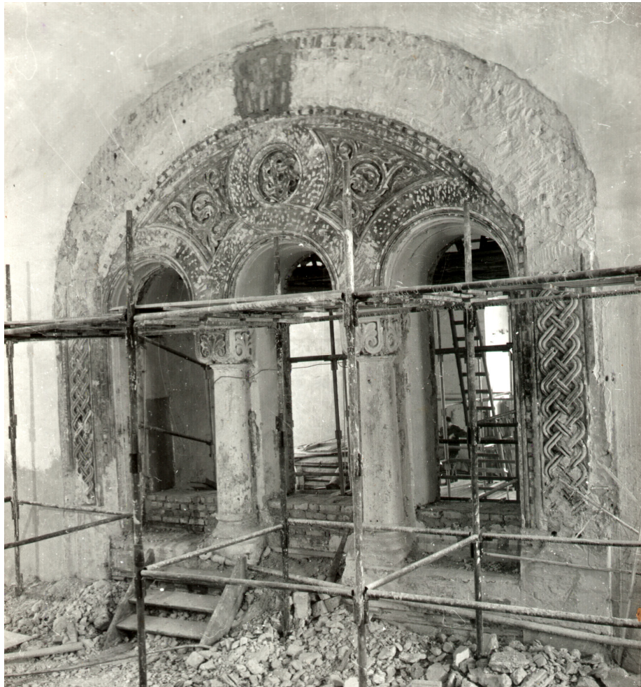
Фрагмент интерьера 1-го яруса колокольни. 1-й этаж. Оформление проемов, связывающих колокольню и переход. (Вид со стороны перехода)
